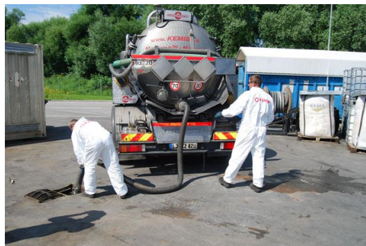
6. Iz kanala se izčrpa tekočino v cisterno
